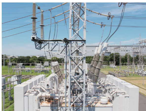
広大な敷地中に多種多彩な変圧器が設置されている
